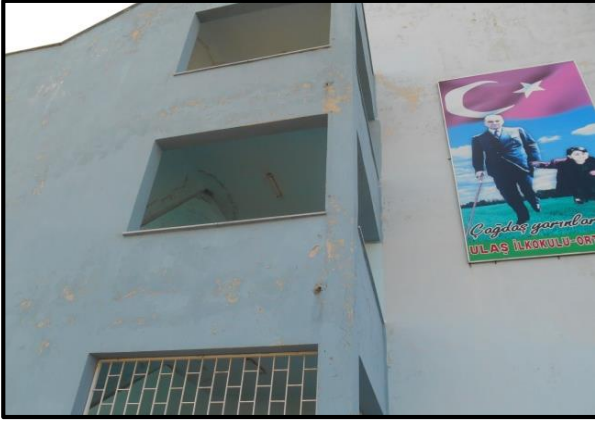
Yangın Merdiveni Tadilattan Önce
