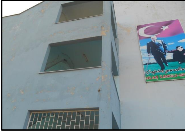
Yangın Merdiveni Tadilattan Önce
